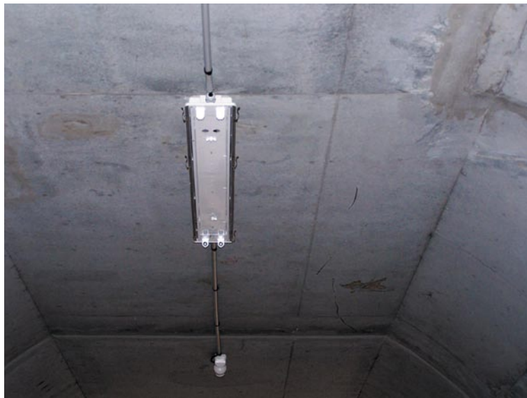
Vol des luminaires
