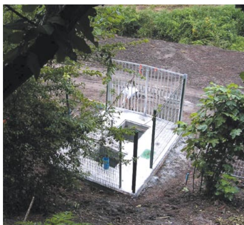
Poste de relèvement chemin de la forêt
